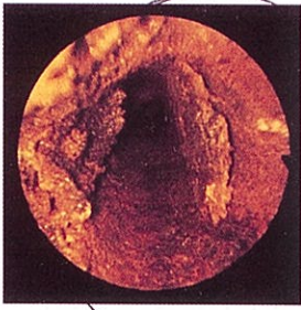
ひどい錆の発生
